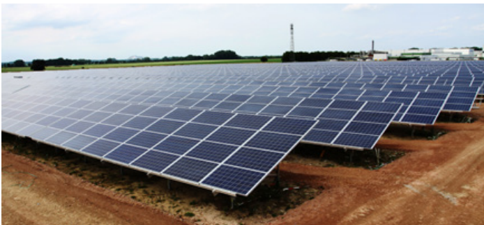
画像1: 発電設備の太陽電池モジュールのストリング
